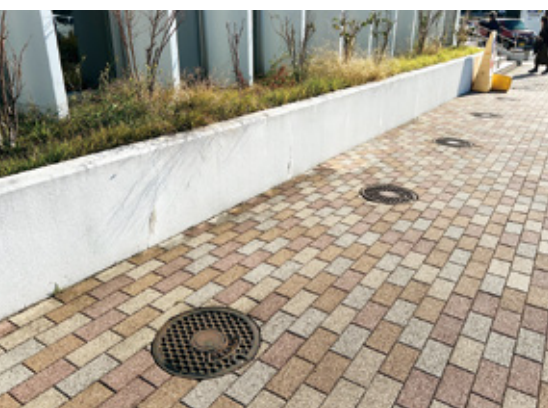
医学部敷地内にあるマンホールトイレ
